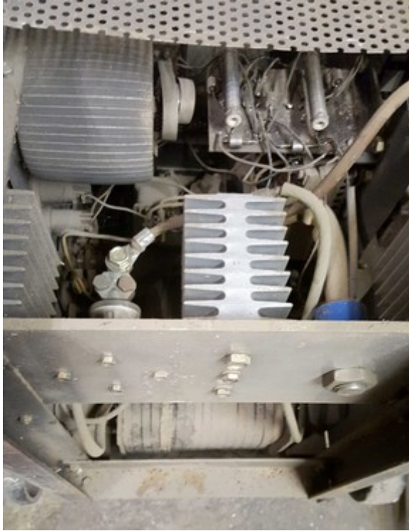
Bild 8: Schweißtrafo – geöffnetes Seitenblech
